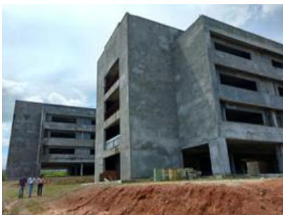
Figura 14: Obras paralisadas de ampliação do Campus dos Malês
